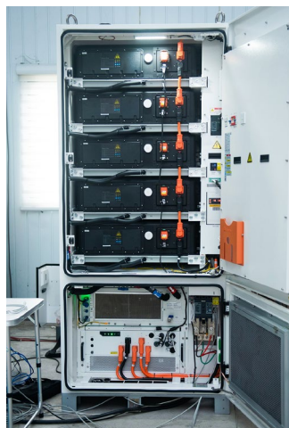
工業用儲能設備。
